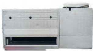
Montageöffnung mit Lüftungskanal
